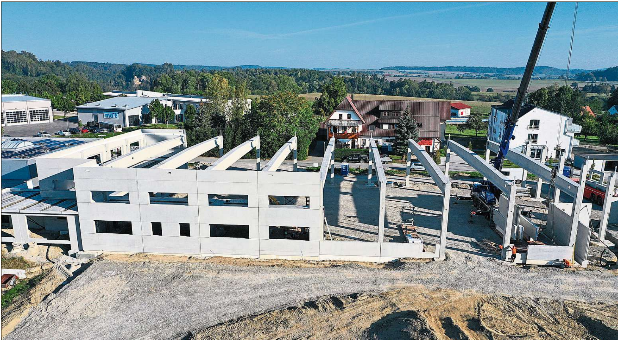
Die Stahlbetonkonstruktion des Carsig-Anbaus auf dem Berner Feld hat Fertigbau Wochner in 14 Tagen erstellt.
