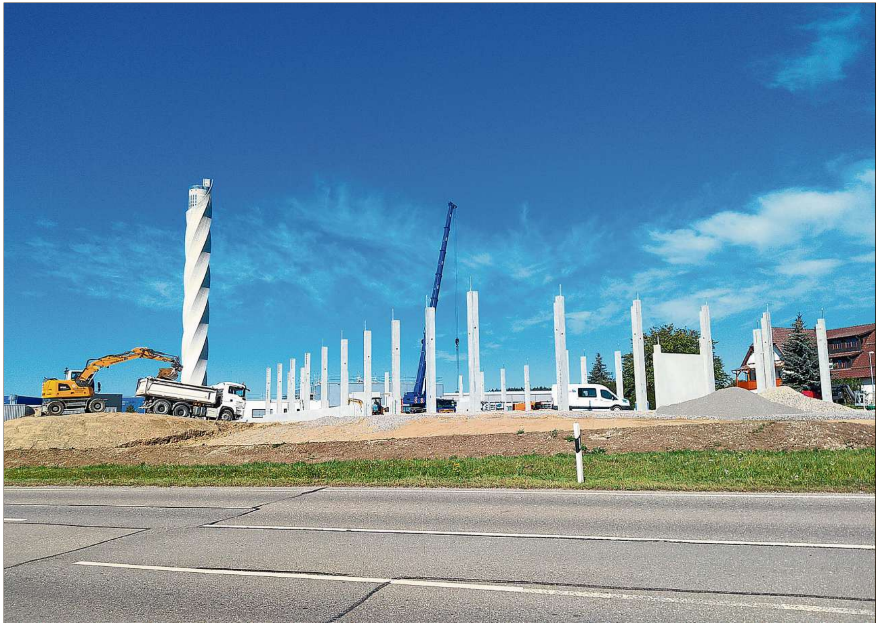
Die Firma Fertigbau Wochner errichtet einen Neubau für die Rottweiler Firma Carsig im Berner Feld.
